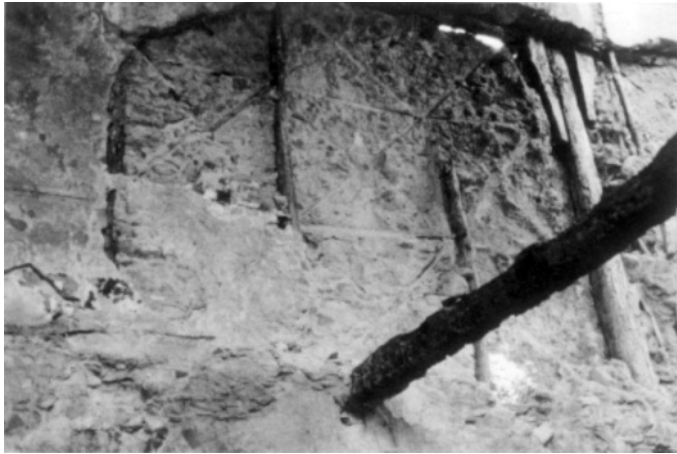
Abb. 2.18: Innenwand eines im Abbruch begriffenen Hauses am Corso Italia in Filadelfia, Detail: ‚x‘-förmige Ausfuchung der Wand; hier sichtbar die Abdrücke der herabgefallenen Holzbalken (Foto: S. Tobriner).
